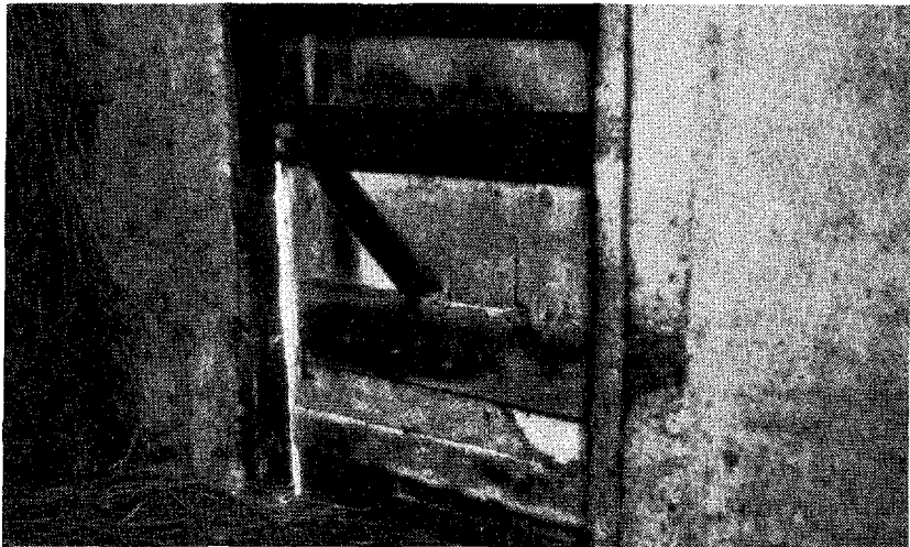
Fig. 47. Kostalddør mod Nord. Bemærk den stærke Rimdannelse og Utæthed, 1 à 3 cm Fuge langs Karmen. Den farlige Træk herfra rammer lige ind paa Dyrenes Bagpartier. Bygget 1922. (Fot. Reinholt Jensen.)
