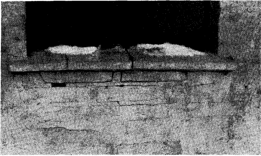
Fig. 80. Beton egner sig daarligt til Saalbænk, en enkelt Svindrevne udvides hurtigt, og den stærke Varmeledning gennem Betonen kan inde under Saalbænken foranledige Dannelse af Svedevand, som yderligere fremskynder Nedbrydningen af Murværket. Bygget 1922. (Fot. Reinh. Jensen.)
