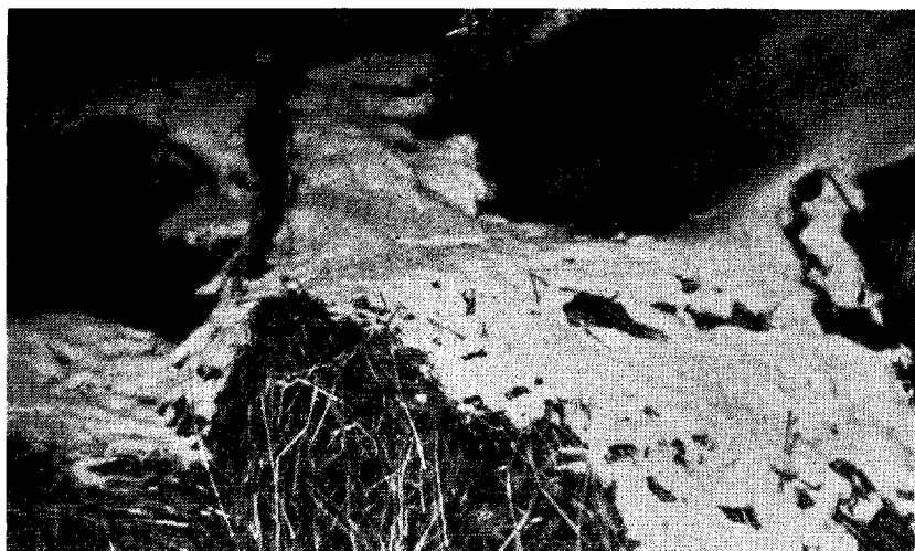
Fig. 79. Følgerne af en utæt Lem i Gavlen, Bygget 1922. (Fot. Reinholt Jensen.)
