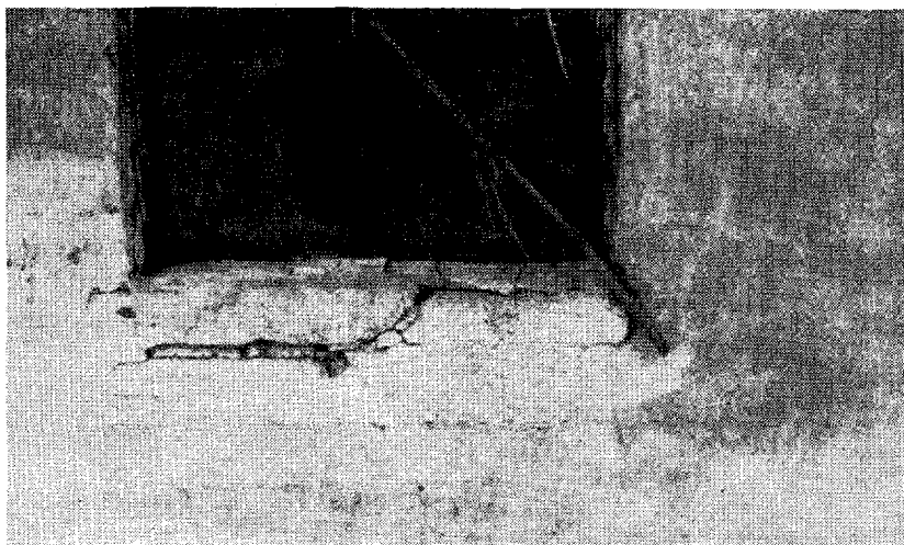
Fig. 41. Staldvindue og Ydermur, hvor Fugten er slaaet igennem. Effektivt Dugvandsafløb gør Stalden lunere og forlænger Bygningens Levetid. Bygget 1922. (Fot. Reinholt Jensen.)
