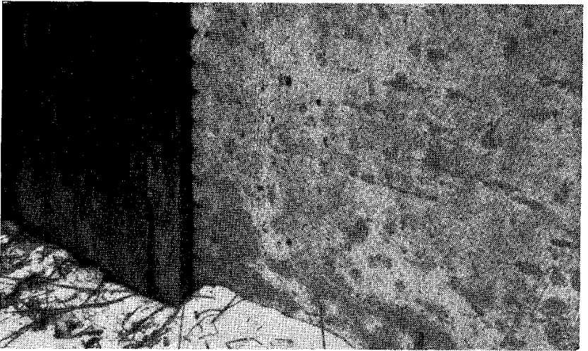
Fig. 9. Denne Stalddør var i Vinteren 1946—47 fastfrosset i omtrent 3 Mdr., den mangler Karm, og der var en Utæthed hele Falsen rundt paa ca. 2 cm, ad hvilken Fuge varm Luft ustandseligt sivede ud foroven og kold Luft ind forneden. Bygget i 1922. (Fot. Reinholt Jensen.)
