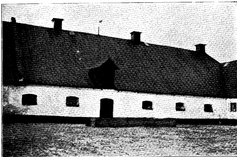
Fig. 9. Træskorstene med uhensigtsmæssige Afdækninger.
