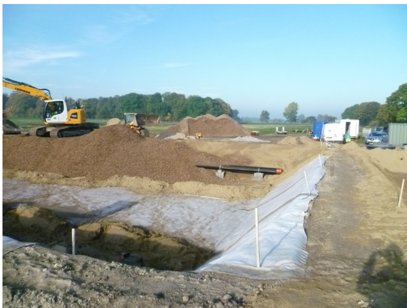
Figur 11. Hovedbassindrænrør understøttet af blokke af beton (Kilde: BM Bogense).
