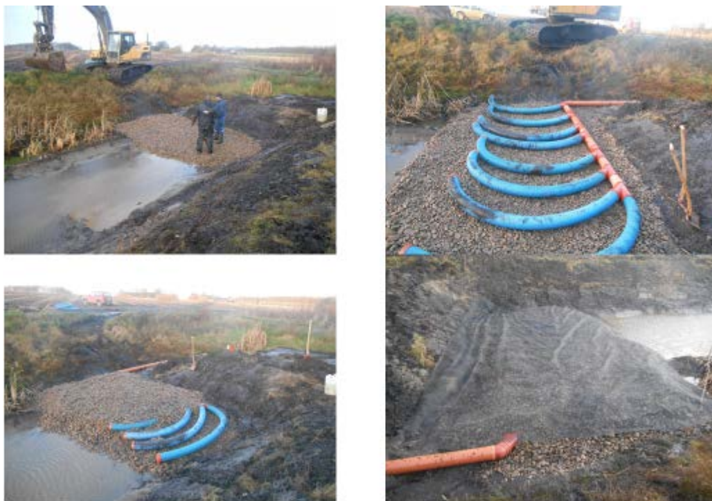
Figur 31. Udløbet fra bioreaktoren ved minivådområder ved Spjald. Man ser de 8 perforerede drænrør der samles i det orange udløbsrør. Rørene ligger i perlesten hvorpå der lagt et net (nederst th.)
